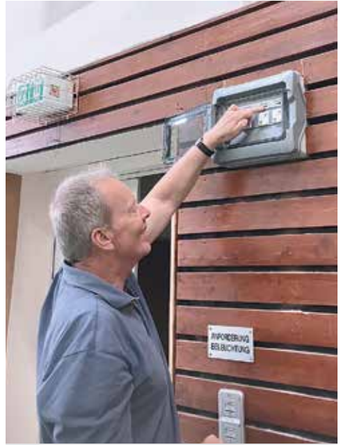
Steuerung der Fenster und der Verschattung.
